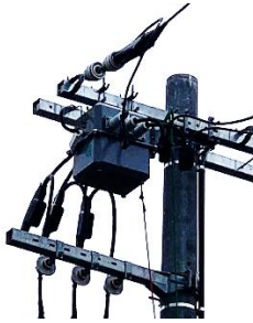
避雷器(LA)・制御電源(VT)内蔵 区分開閉器(SOG)の例
